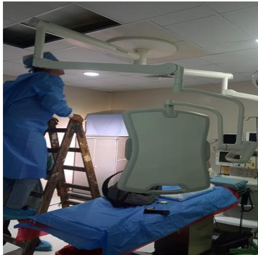
Figura 16. Inspección de equipo
