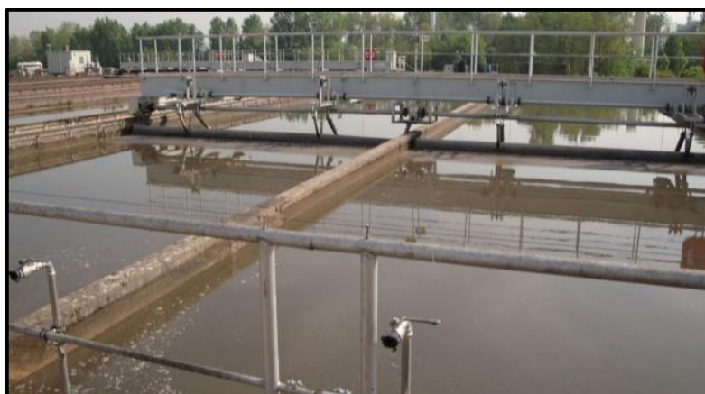
Figura 13. Batería de sedimentadores primarios en funcionamiento
