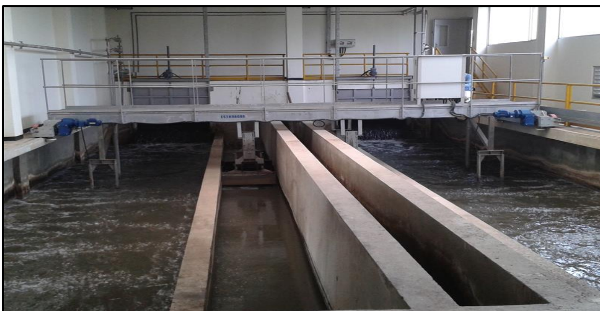
Figura 11. Vista de un desengrasador en funcionamiento
