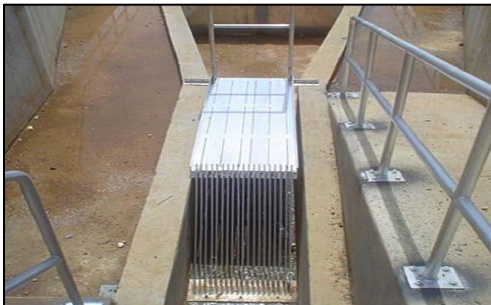
Figura 7. Vista de una cámara de rejillas
