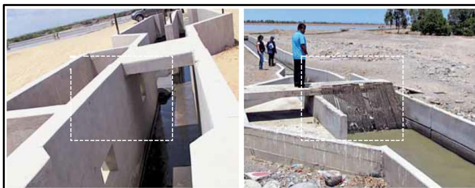
Figura 1. Cámara de rejas mal diseñadas
