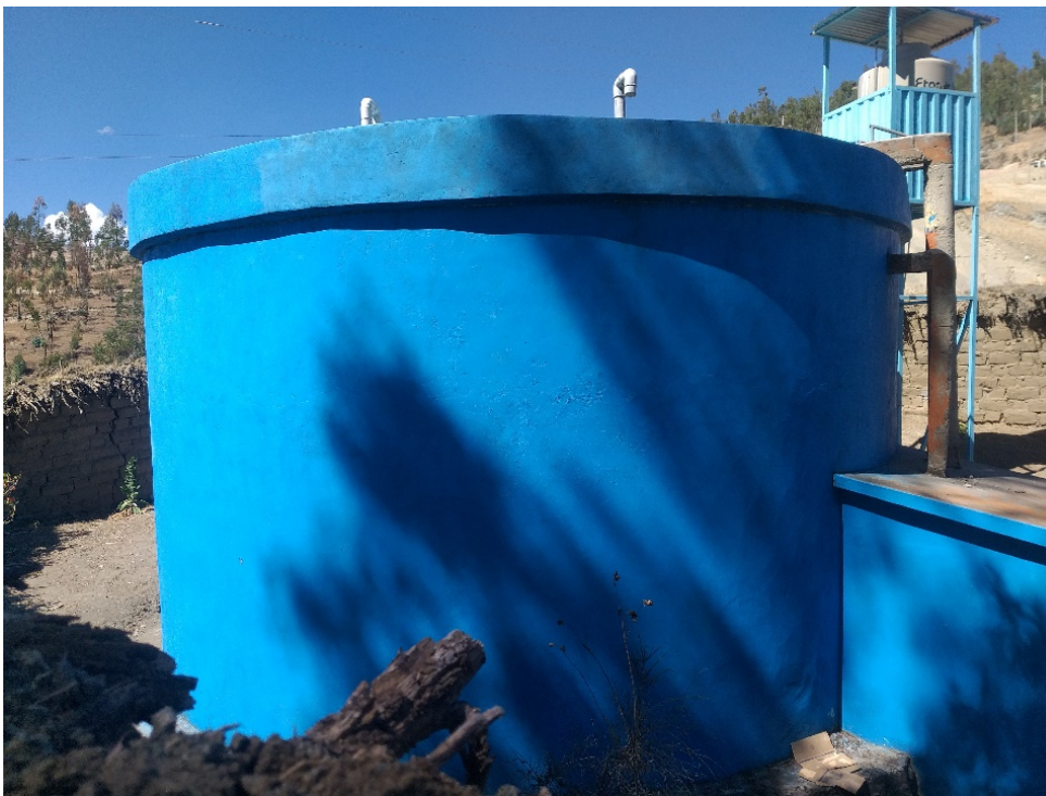
Figura 12: Reservorio de 150m 3
