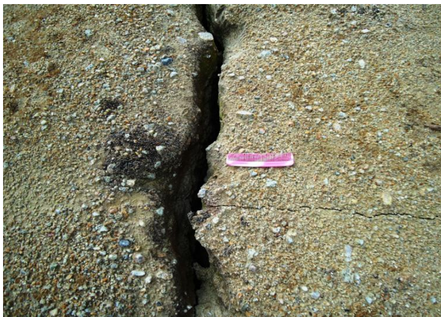
Figura 5: Dimensión de las grietas y gravosidad del depósito
