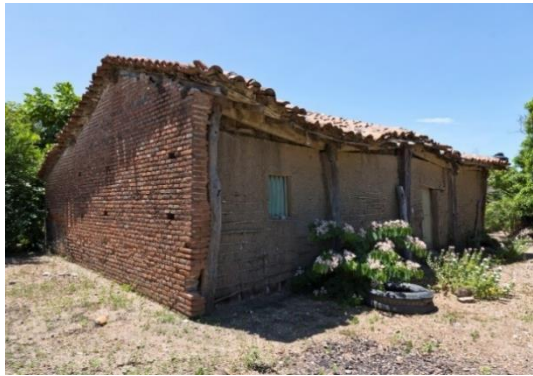
Figura 5 Vivienda de adobe afectada por inadecuada autoconstrucción
