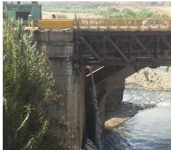
Figura 2: Tubería de agua residual domestica localizada debajo del puente Huaura
