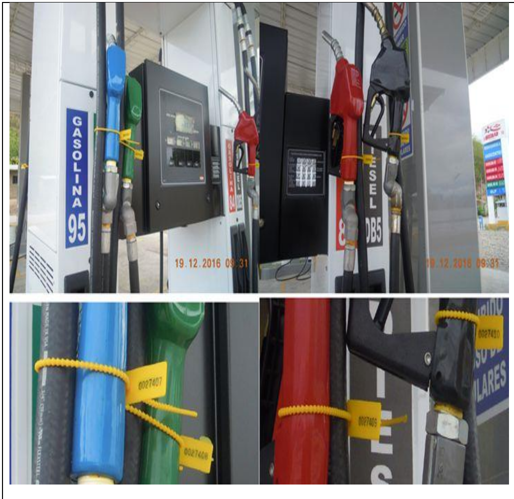
En estas tomas se aprecia los precintos colocados a los surtidores del establecimiento ejecutándose una medida de seguridad.
