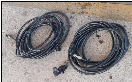
Figura 12. Manguera hidráulica con fuga
