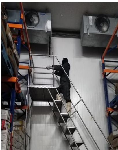
Figura 9: Área de cámara frigorífica
