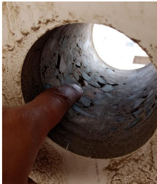
Figura 15: En la vista se aprecia la perforación realizada en la columna del cuarto principal.
