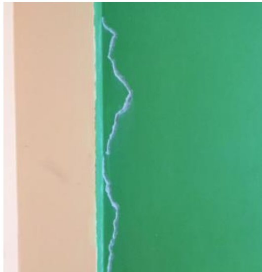
Figura 9: Rajaduras en los muros
