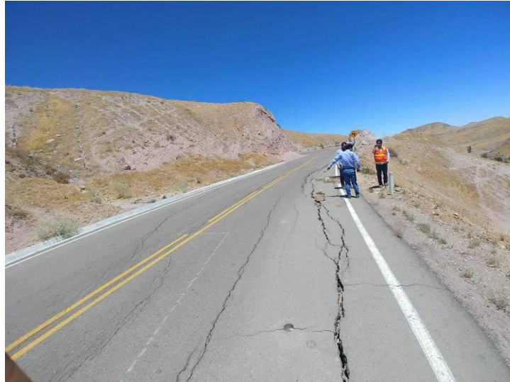
Figura 1. Carretera asfaltada con deformaciones permanentes
