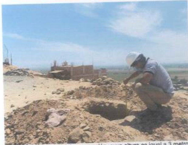
Se toma la profundidad de excavación, cuya altura es igual a 3 metros
