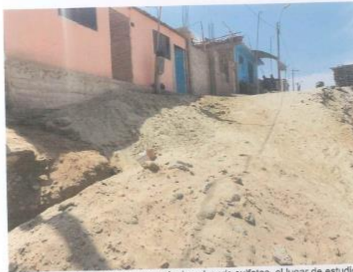
Se observa claramente la presencia de sales y/o sulfatos, el lugar de estudio tiene pendientes que varían conforme a la altura.
