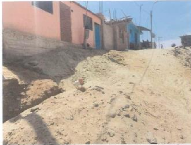
Se observa la presencia de sales y sulfatos en el lugar de estudio
