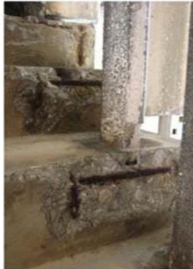
Figura N° 03: Desprendimiento de concreto (Paredes, Prieto, Santos, 2013)
