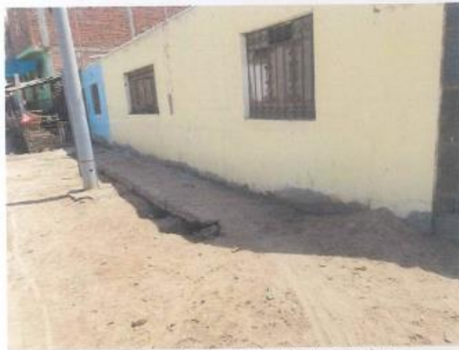
Presencia de sulfatos en la base de una estructura
