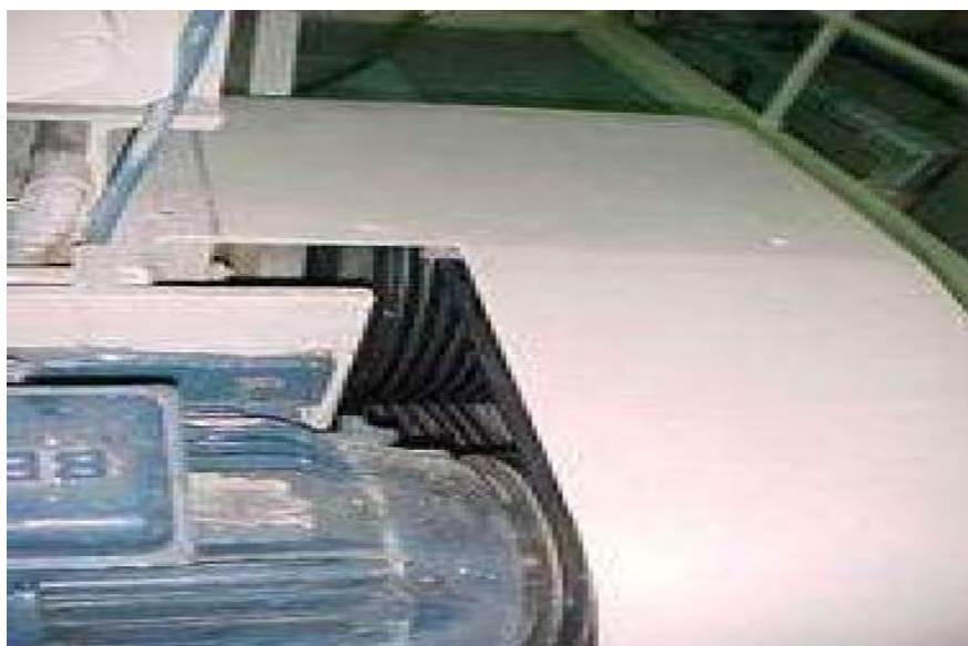
Figura 28. Mejorar accesibilidad de lugares de difícil acceso (LDA)
