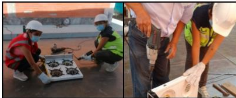
Figura 21. Perforación lateral de la cocina
