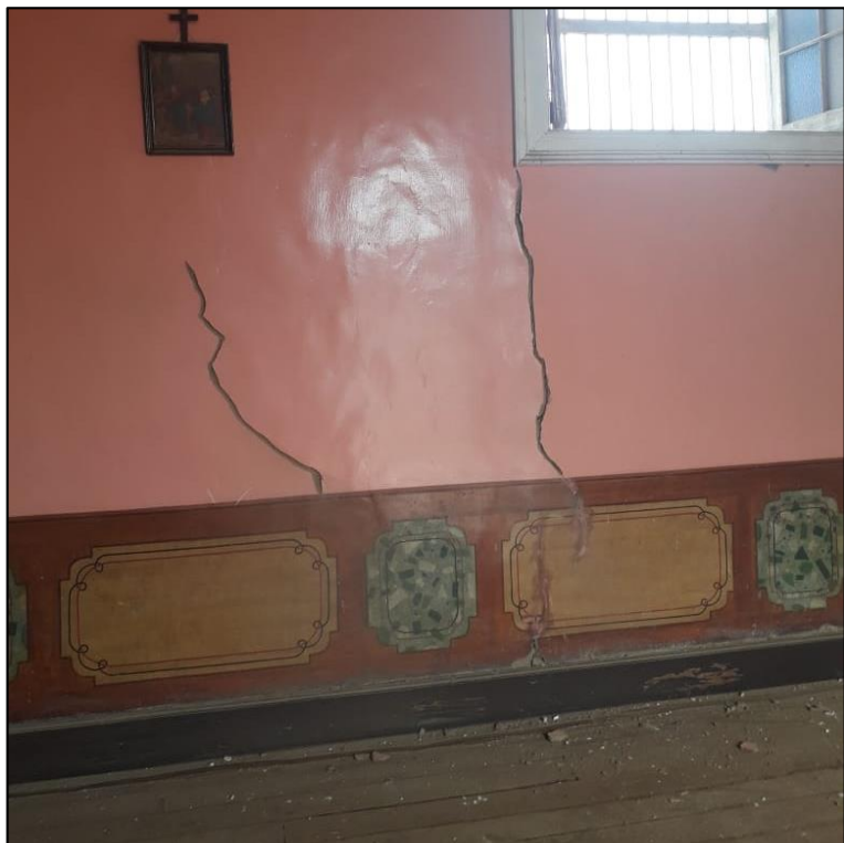
Fotografía 5. Fallas en muros.
