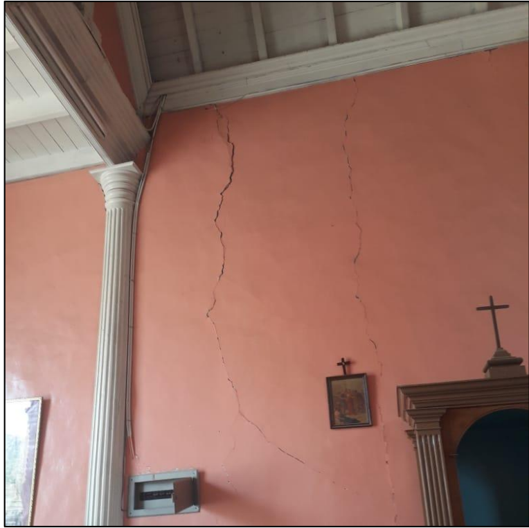
Fotografía 4. Fallas en muros.
