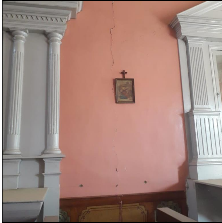
Fotografía 6. Fallas en muros.
