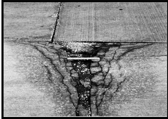
Figura 8. Grieta de Durabilidad "D"
