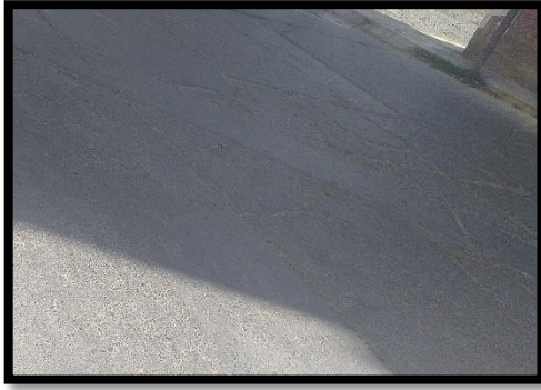
Figura 17. Grietas de Retracción
