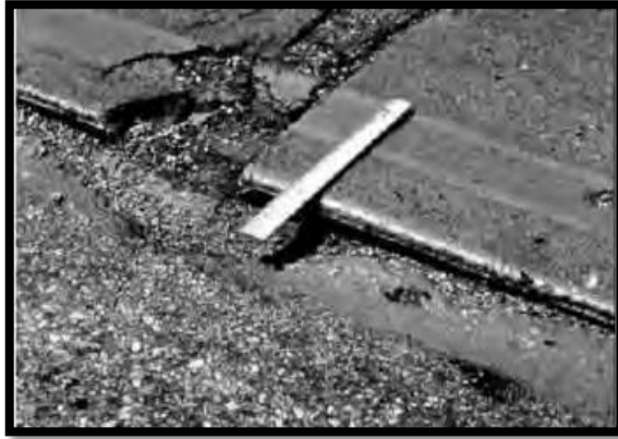
Figura 11. Desnivel Carril / Berma
