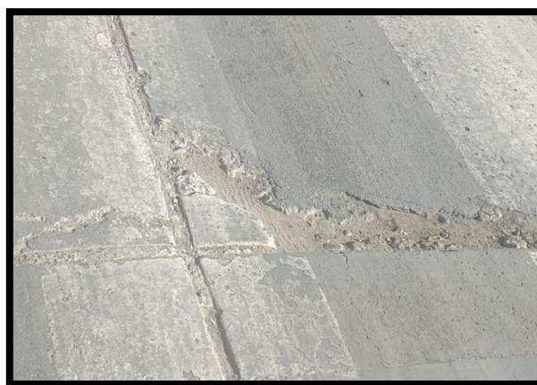
Figura 7. Grieta de Esquina
