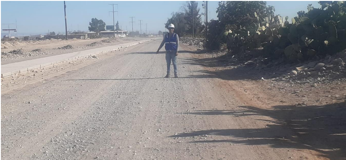
Figura 4. Base de una carretera deteriorado
