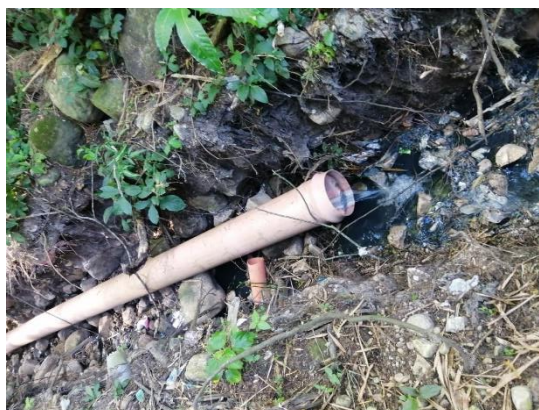
Figura 4. Identificación de fuente contaminante de agua.
