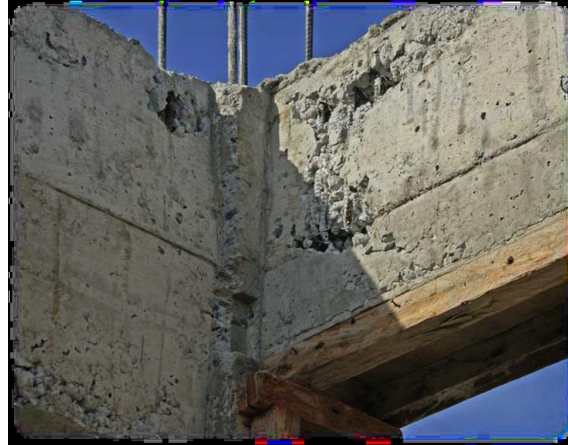
FIGURA N° 7 Segregación del Concreto
