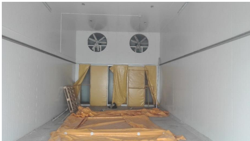
Figura 2. Túnel de frío.
