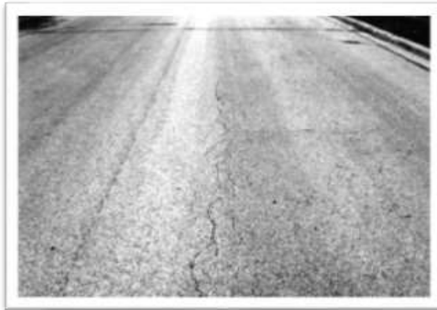
Figura 3: Piel de cocodrilo, severidad baja
