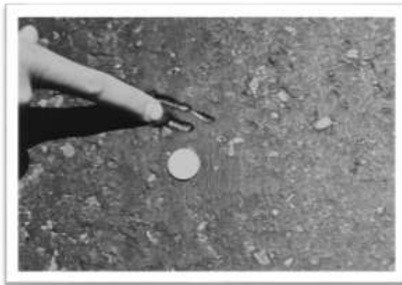
Figura 7: Exudación, severidad media
