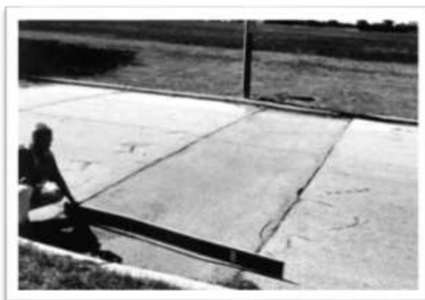
Figura 34: Parchado y acometida de servicio, severidad media
