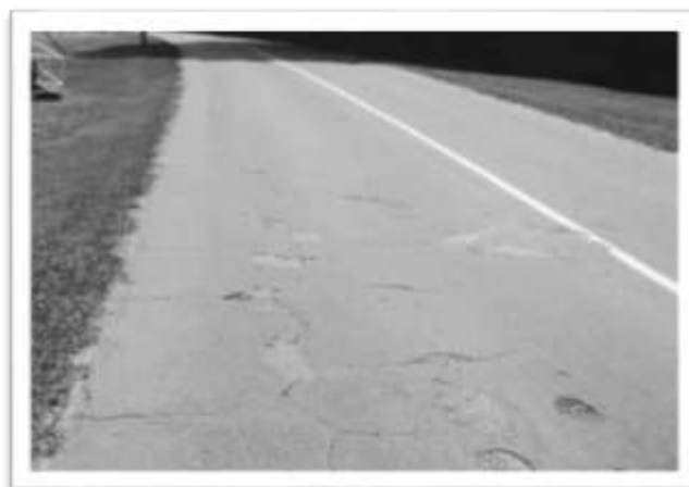
Figura 55: Meteorización/desprendimiento de agregados, severidad alta
