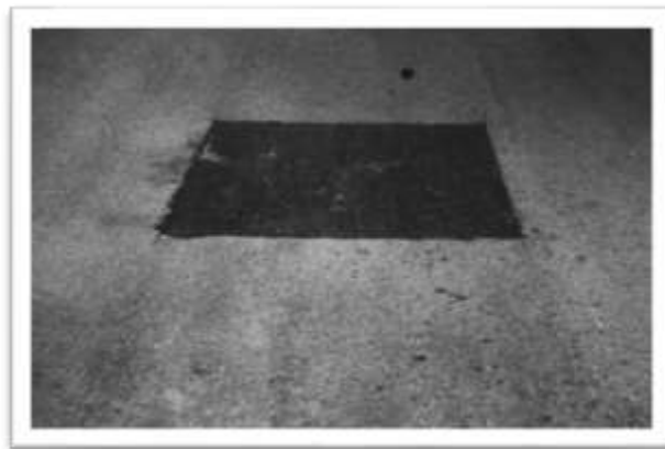
Figura 33: Parchado y acometida de servicio, severidad baja
