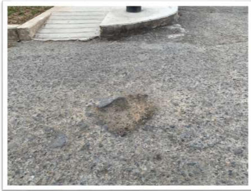
Figura 73: Identificación de falla huecos.
