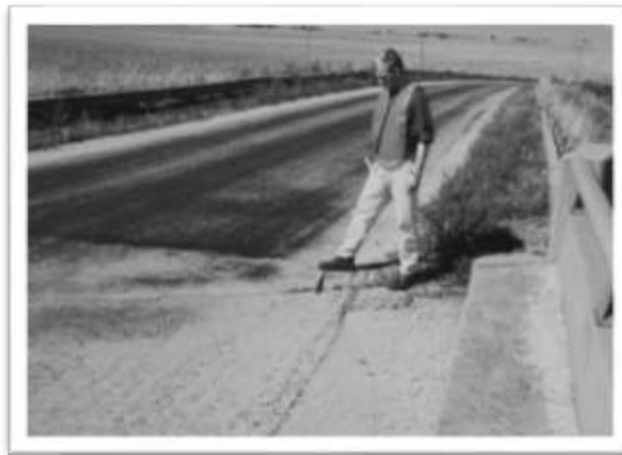
Figura 46: Desplazamiento, severidad baja
