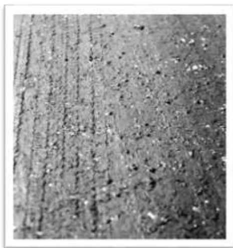
Figura 8: Exudación, severidad alta
