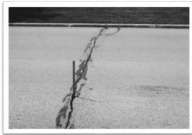
Figura 31: Grietas longitudinales y transversales, severidad media
