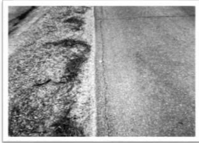
Figura 21: Grieta de borde, severidad baja
