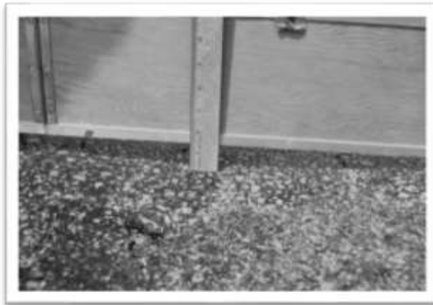
Figura 45: Ahuellamiento, severidad alta
