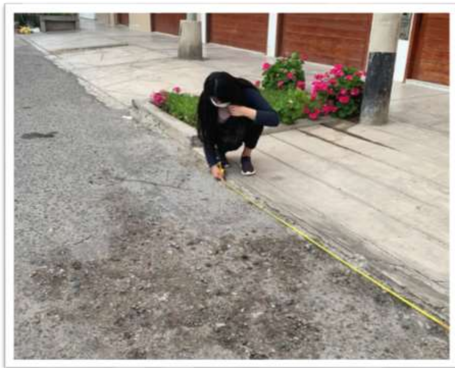
Figura 66: Identificación de falla desprendimiento de agregados.
