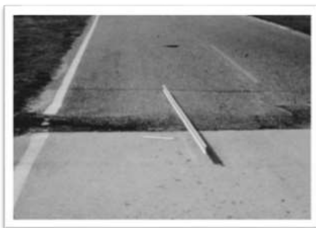
Figura 48: Desplazamiento, severidad alta
