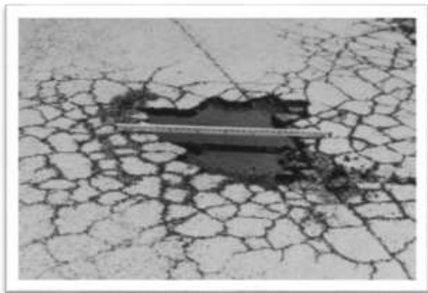
Figura 39: Huecos, severidad alta
