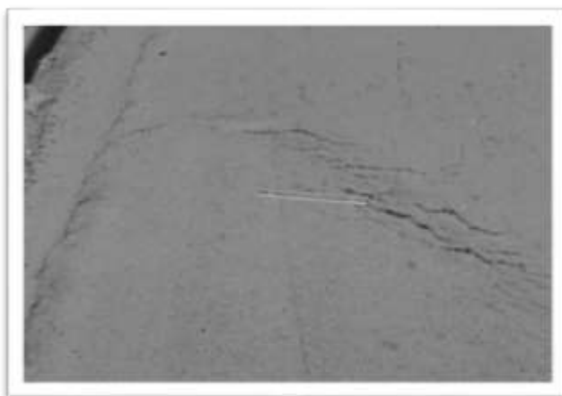
Figura 50: Grieta parabólica, severidad media
