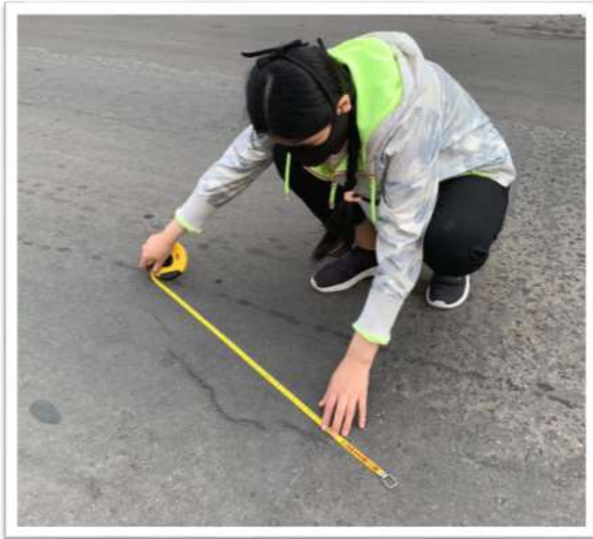
Figura 69: Medición de falla grietas longitudinales y transversales.
