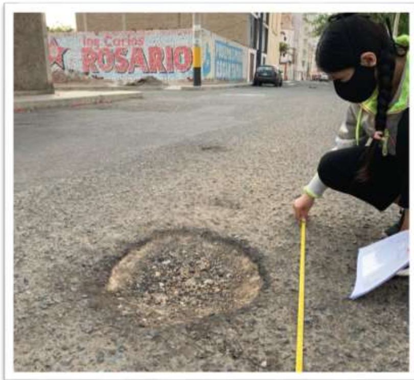
Figura 70: Medición de falla huecos.
