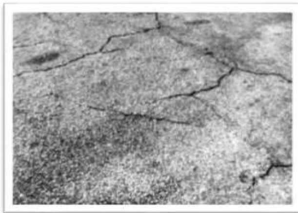
Figura 11: Agrietamiento en bloque, severidad alta
