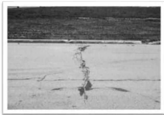
Figura 32: Grietas longitudinales y transversales, severidad alta
