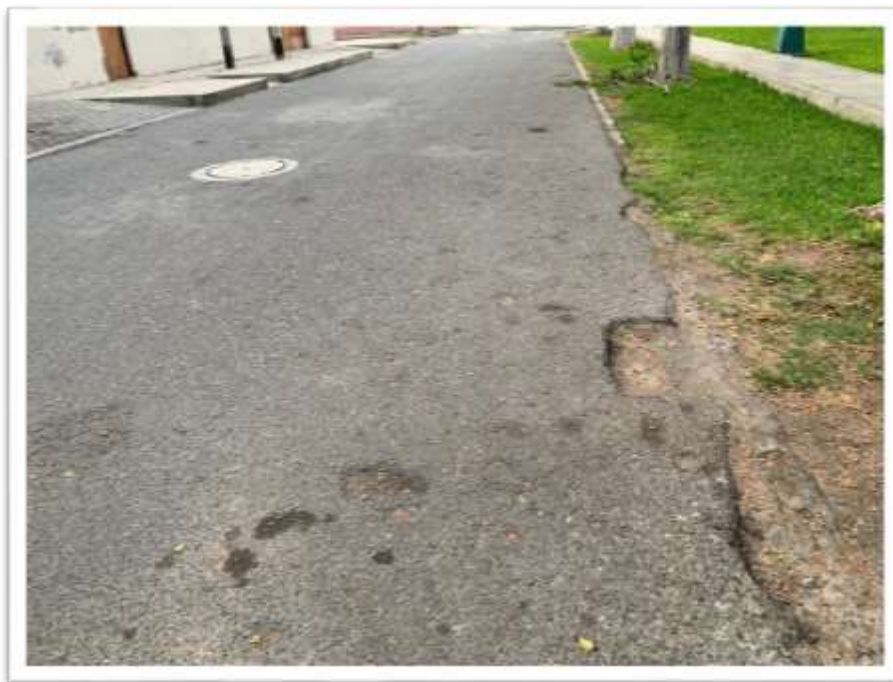
Figura 72: Identificación de falla grieta de borde.
