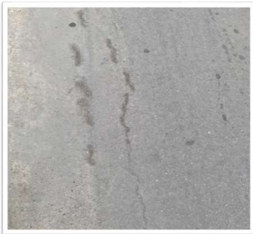
Figura 74: Identificación de falla grietas longitudinales y transversales.
