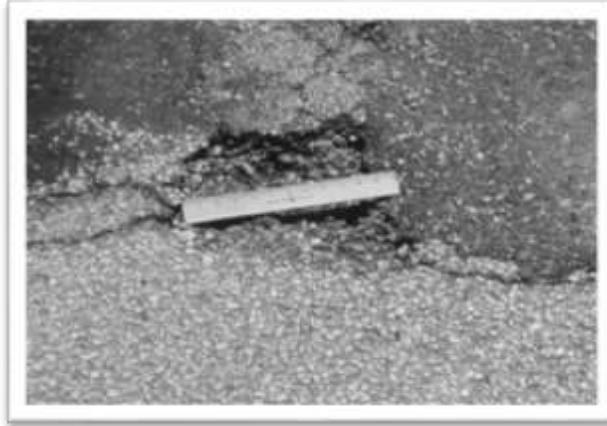
Figura 37: Huecos, severidad baja
