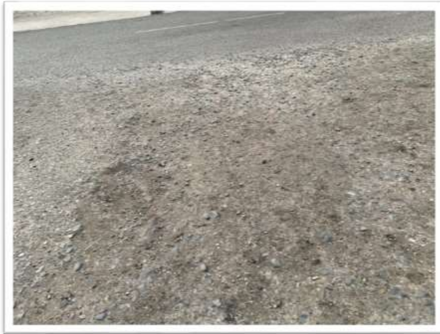
Figura 71: Identificación de falla meteorización de agregados.
