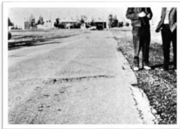
Figura 13: Abultamientos y hundimientos, severidad media
