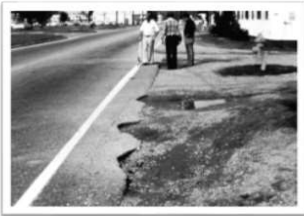
Figura 23: Grieta de borde, severidad alta
