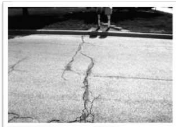
Figura 10: Agrietamiento en bloque, severidad media
