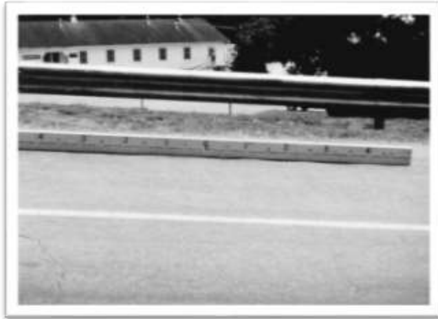
Figura 15: Corrugación, severidad baja
