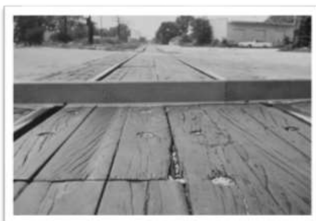
Figura 40: Cruce de vía férrea, severidad baja
