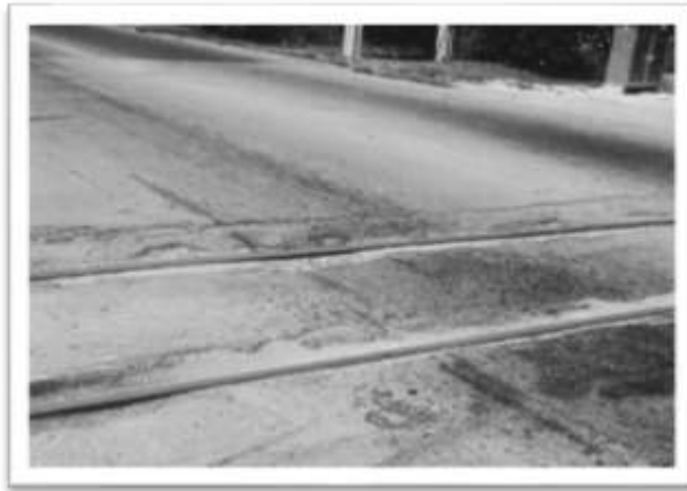
Figura 41: Cruce de vía férrea, severidad media
