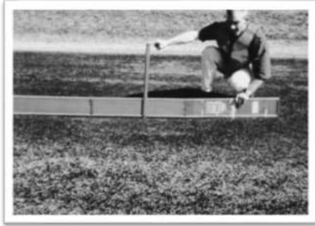
Figura 18: Depresión, severidad baja
