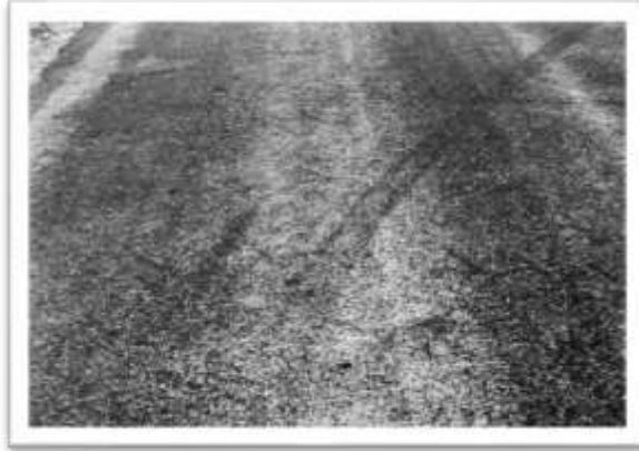
Figura 6: Exudación, severidad baja
