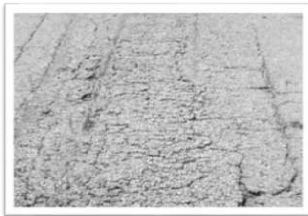
Figura 54: Meteorización/desprendimiento de agregados, severidad media
