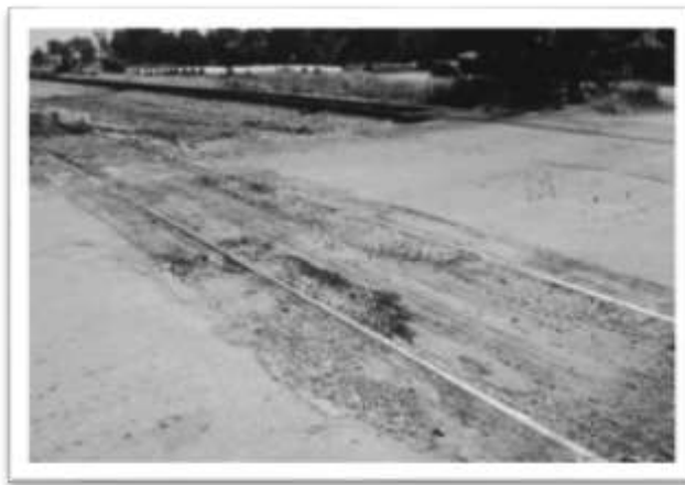
Figura 42: Cruce de vía férrea, severidad alta
