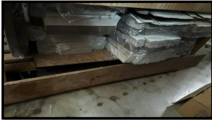
Anexo 7: Techo en malas condiciones que perjudican el ambiente laboral
