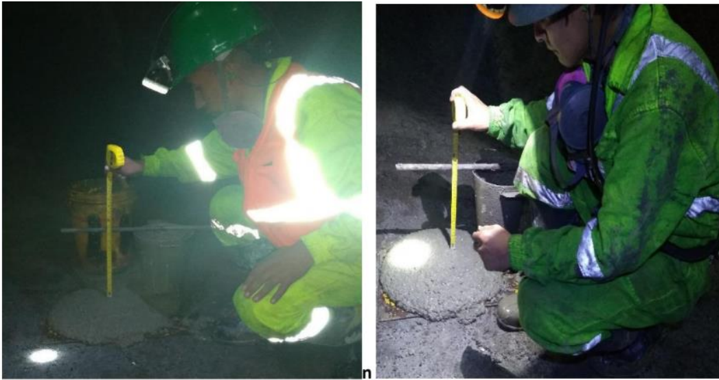
Figura 19. Ensayo de slump en planta shotcrete y en la rampa principal nivel 21. Fuente: Elaboración propia.
