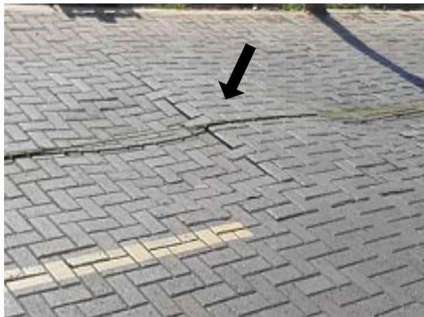
Figura 7. Deterioro por Abultamiento
