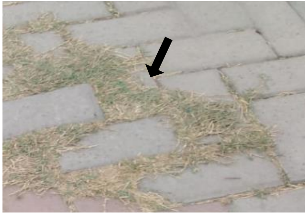
Figura 6. Deterioro por Vegetación en Calzada
