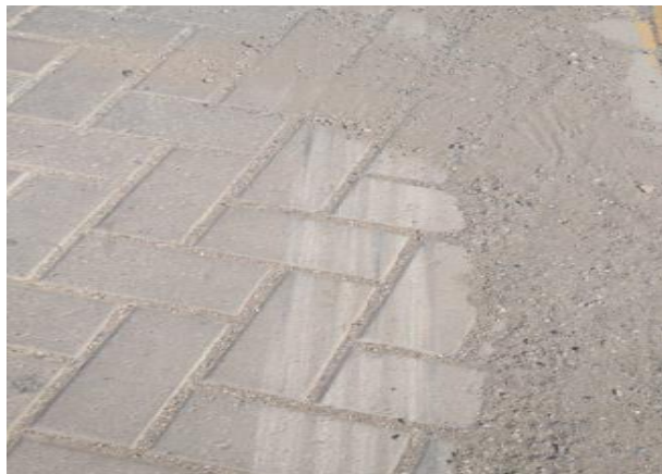
Figura 5. Deterioro por Perdida de Arena
