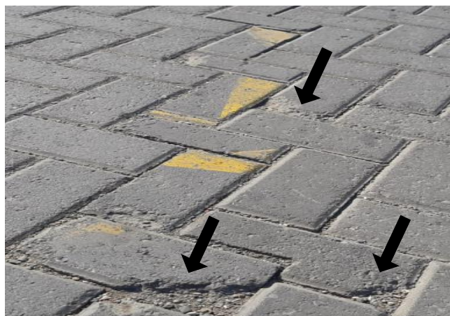
Figura 3. Deterioro por Fracturamiento
