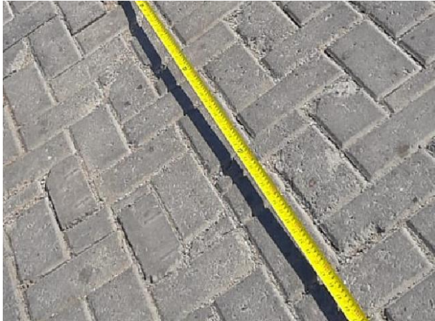
Figura 8. Deterioro por Desgaste Superficial
