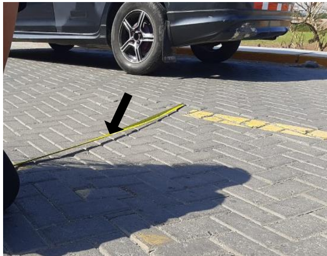
Figura 2. Deterioro por depresión
