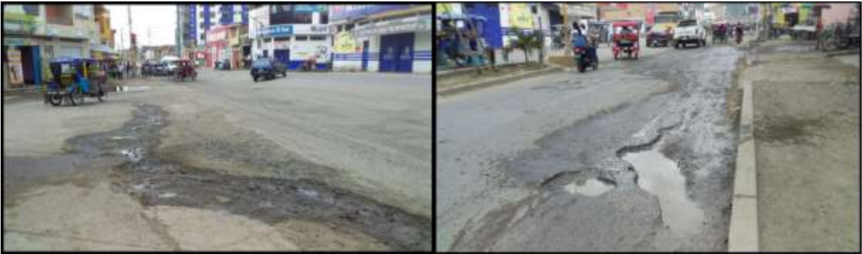
Figura 1. Deterioro de la Av. Pakamuros Fuente: Fotografía tomada por tesistas
