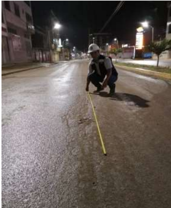
Figura 19. Piel de cocodrilo tramo 2+250 – 2+295
