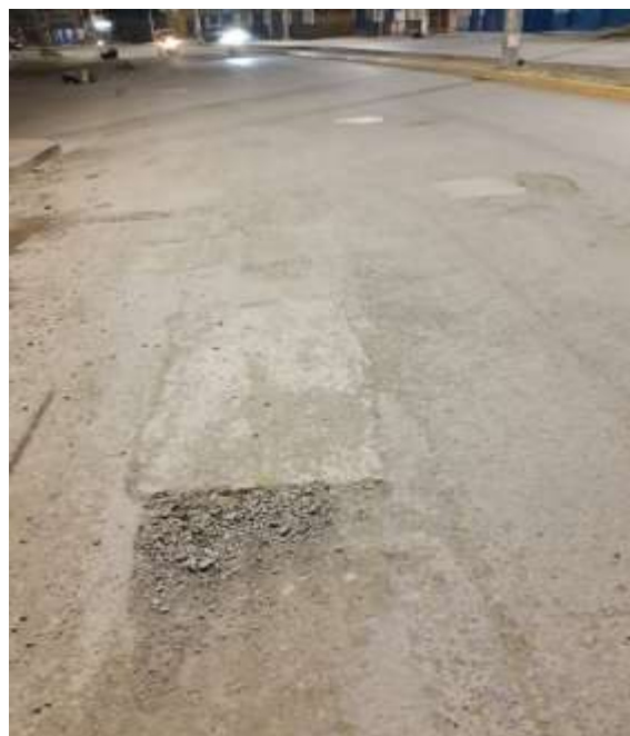
Figura 20. Parches del tramo 2+250 - 2+295
