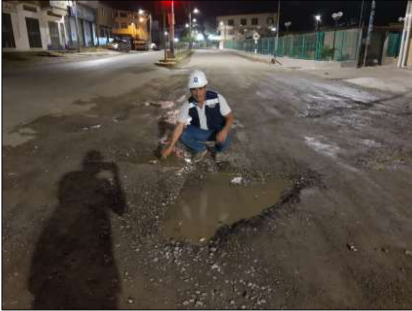
Figura 21. Huecos en el tramo 2+475 - 2+500
