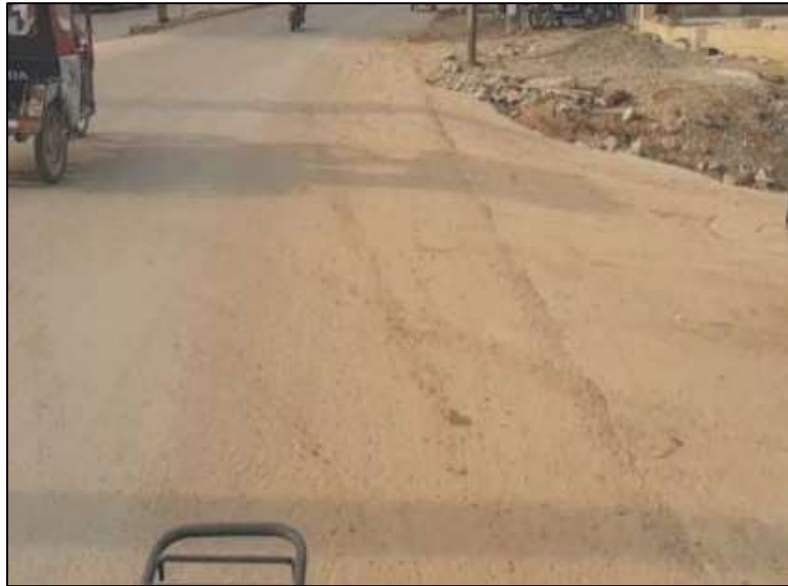
Figura 15. Desnivel Carril - berma tramo 0+675 – 0+720
