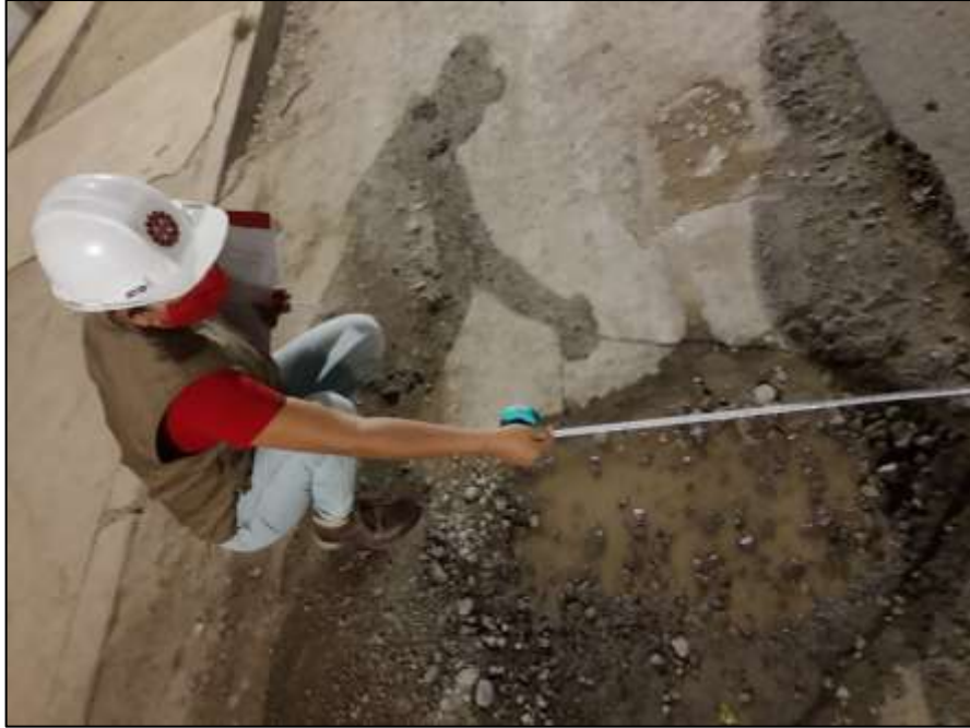
Figura 17. Huecos en el tramo 2+025 - 2+070
