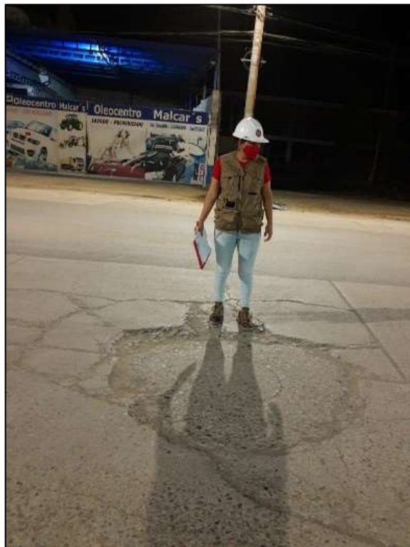
Figura 16. Fisura de bloque tramo 1+800 – 1+845
