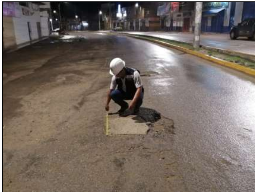
Figura 18. Parches en el tramo 2+025 - 2+070
