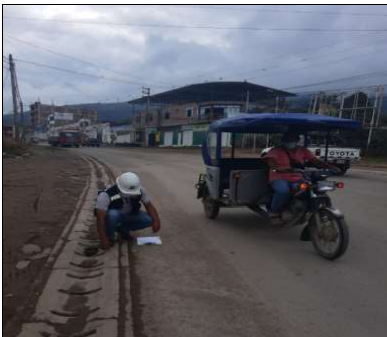
Figura 14. Fisura de borde tramo 0+450 - 0+495
