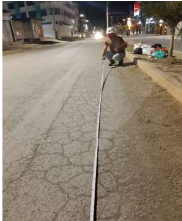
Figura 22. Piel de cocodrilo en tramo 2+475 - 2+500
