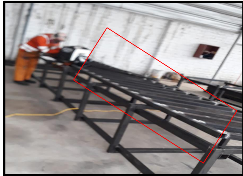
Figura 30. Inclinación de baranda
