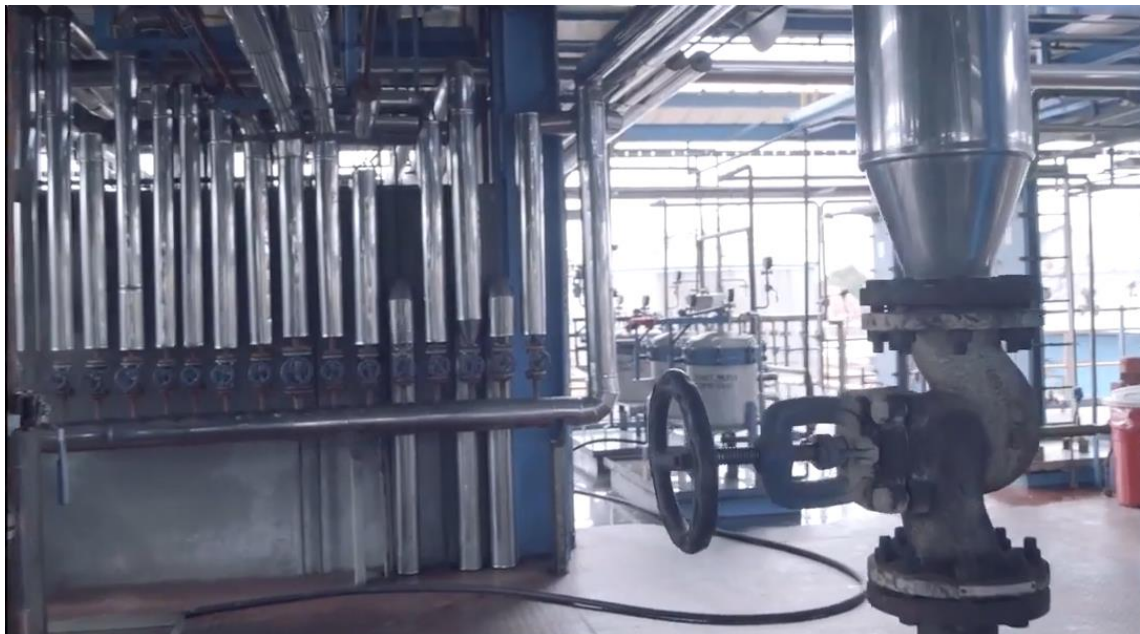
Área de filtrado
