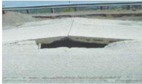
Figura 1: Falla de levantamiento de losas
