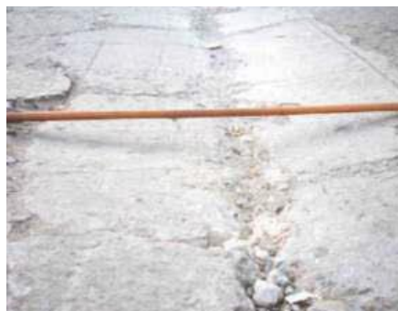
Figura 21: Falla de punzonamiento
