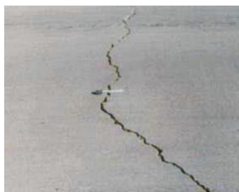
Figura 13: Falla de grieta lineal, grieta transversal
