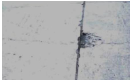
Figura 25: Falla de descascaramiento en la junta
