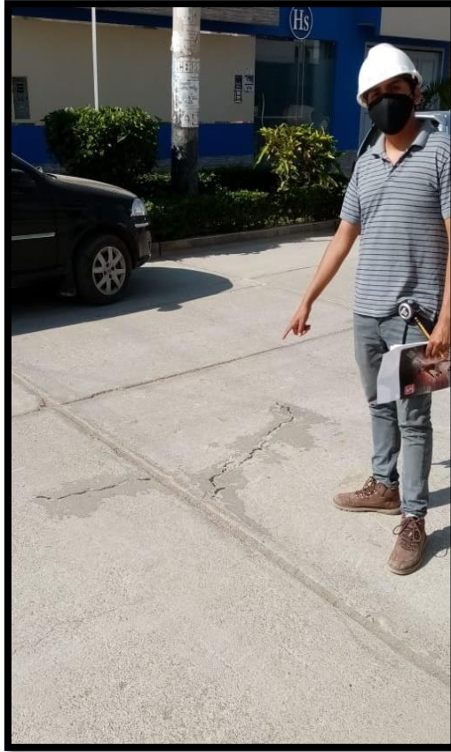
Tomas fotográficas de fallas en calle La Libertad
