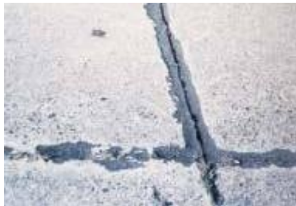
Figura 7: Falla de sello de junta, extrusión del sellante
