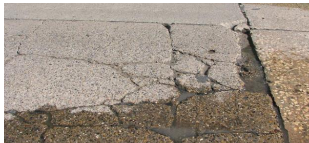
Figura 24: Falla de descascaramiento de esquina
