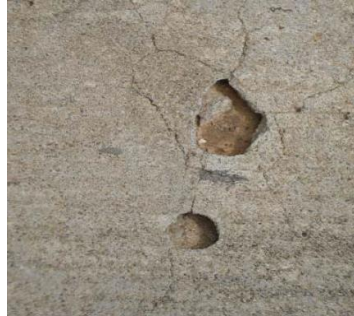
Figura 19: Falla de popouts
