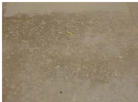
Figura 17: Falla de Pulimiento de agregados, toma 01
