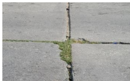
Figura 8: Falla de sello de junta, crecimiento de vegetación
