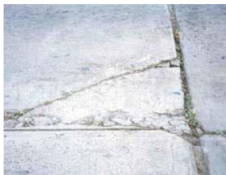
Figura 2: Falla de grieta de esquina
