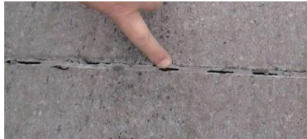
Figura 6: Falla de sello de junta, desprendimiento del sellante
