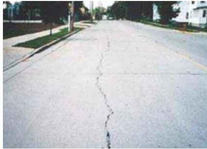
Figura 14: Falla de grieta lineal, grieta longitudinal
