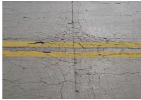
Figura 4: Falla de grieta de durabilidad “D”
