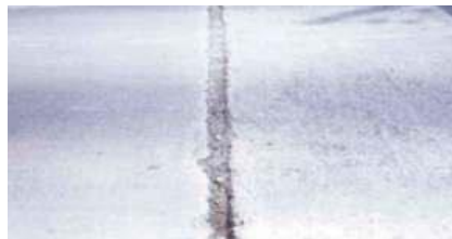
Figura 11: Falla de sello de junta, falta de sellante en la junta
