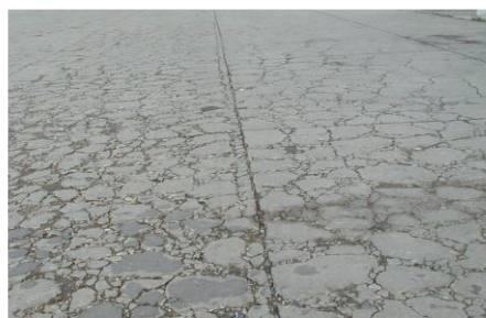
Figura 22: Falla de descascaramiento
