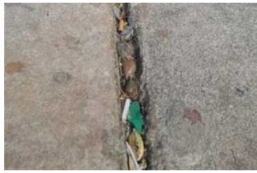
Figura 9: Falla de sello de junta, endurecimiento del material llenante
