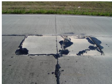
Figura 16: Falla de parche grande
