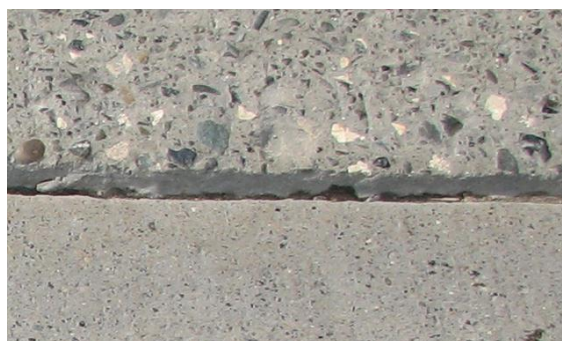
Figura 18: Falla de pulimiento de agregados, toma 02
