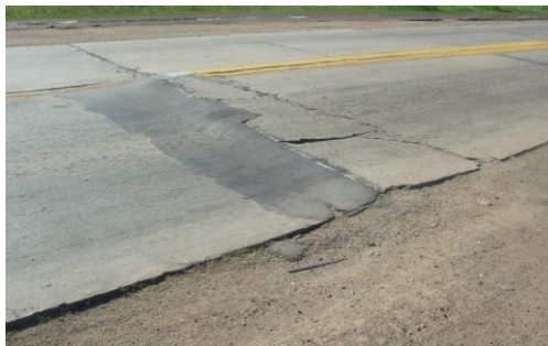
Figura 15: Falla de parche grande
