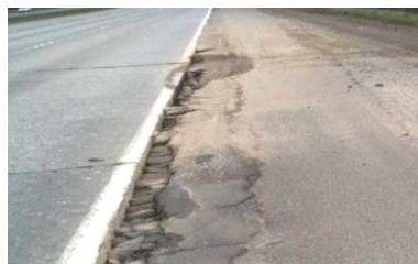
Figura 20: Falla de bombeo
