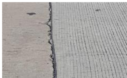
Figura 10: Falla de sello de junta, perdida de adherencia
