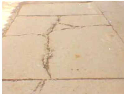
Figura 3: Falla de losa dividida
