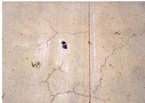
Figura 23: Falla de grietas de retracción
