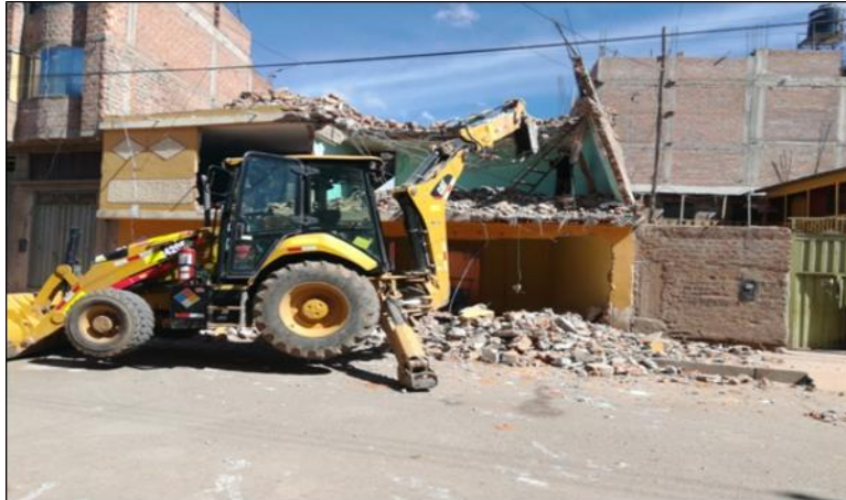
Figura 11. Residuos de construcción y demolición en Juliaca
