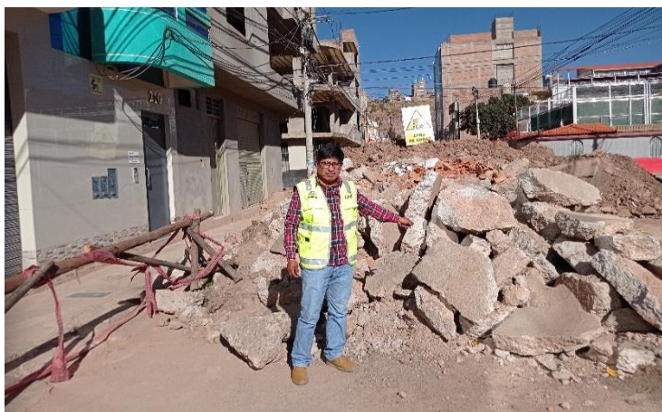
Figura 3. Escombros de pavimentos dificultando la transitabilidad
