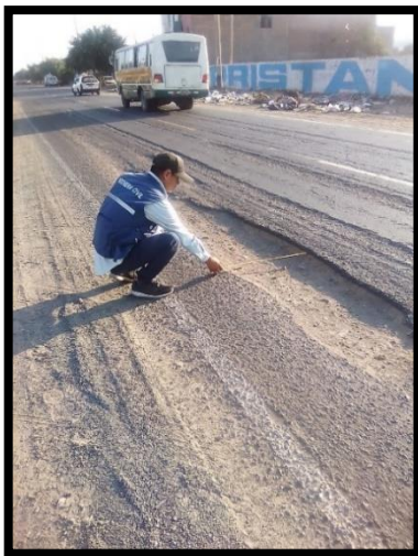
Imagen 14: Patología: baches o huecos.
