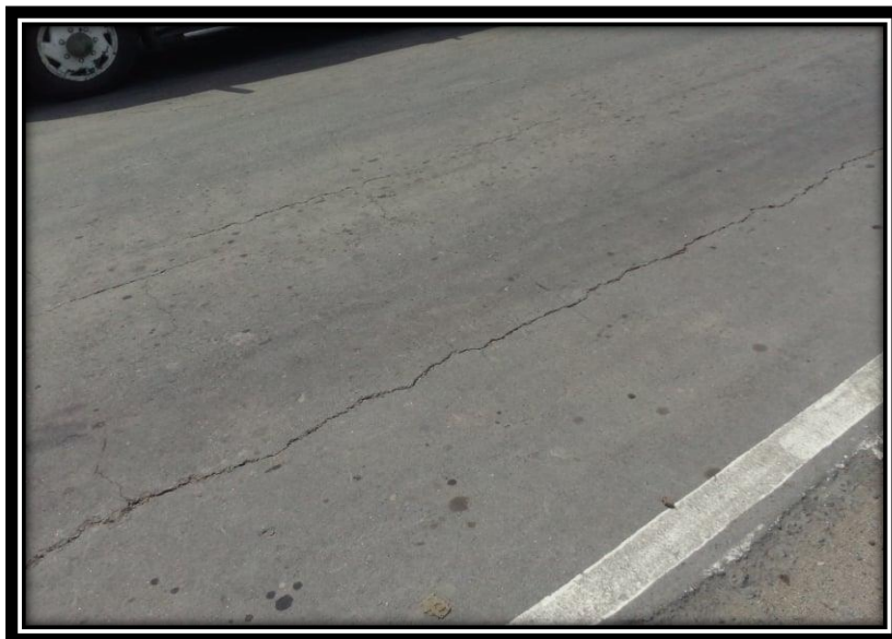
Imagen 2: Patología: Fisuras longitudinales
