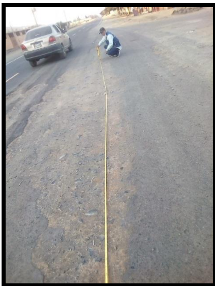
Imagen 16: Patología muy severa, que impide el tránsito.
