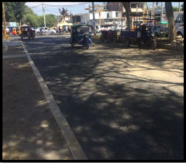
Figura 29. Grieta de Borde
