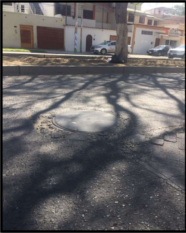
Figura 25. Desprendimiento de Agregado
