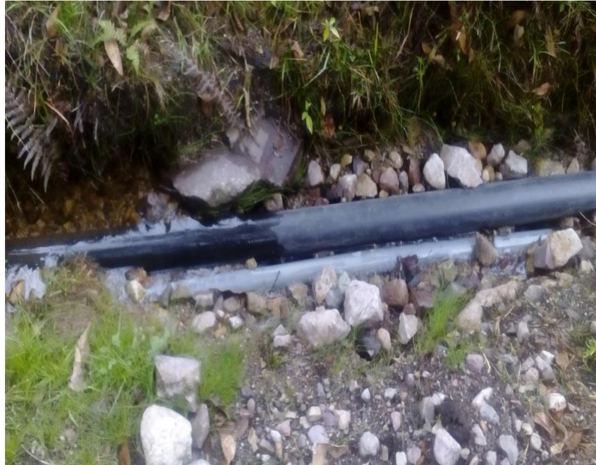
Figura 10. Tubería de distribución del sistema actual con fuga de agua Fuente: Elaboración propia.
