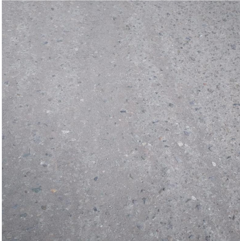
Figura 4. Zona de investigación, condiciones de la vía, pérdida de finos. Nota. Elaboración propia.
