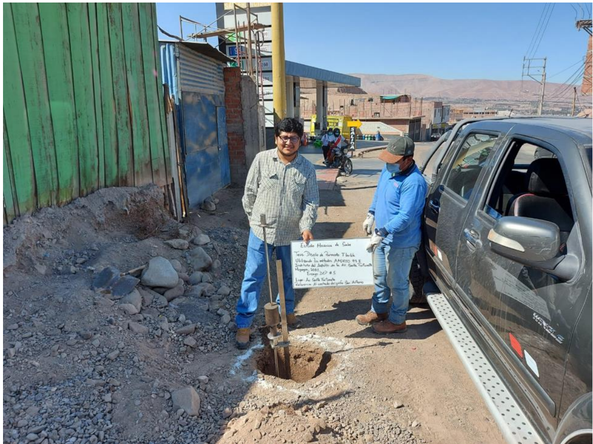
Fotografía 6. Punto 5 ensayo normal para el uso del D.C.P. en aplicaciones de pavimentos a poca profundidad ASTM 06951.
