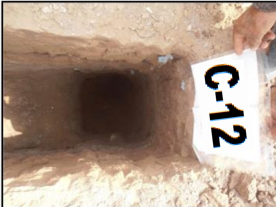
Figura 10 Vista de los Estratos en la Calicata N° 12
