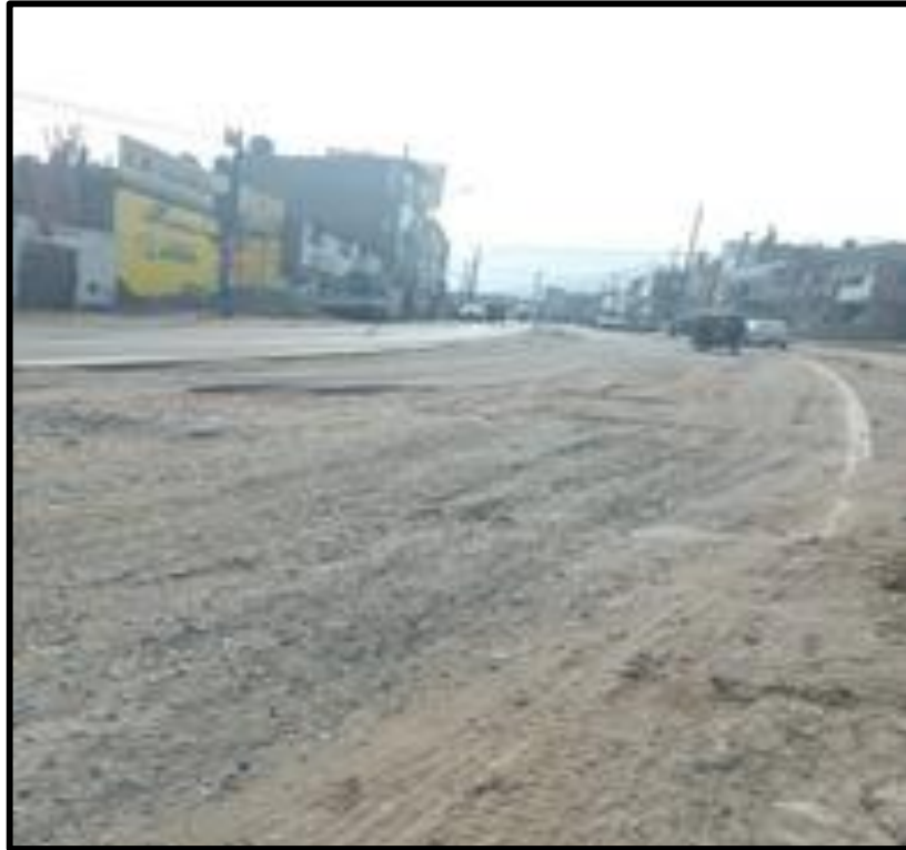
Figura 2: Pavimento en estado de deterioro
