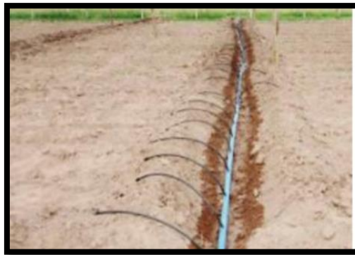
Figura 6. Tuberías de conducción y laterales.
