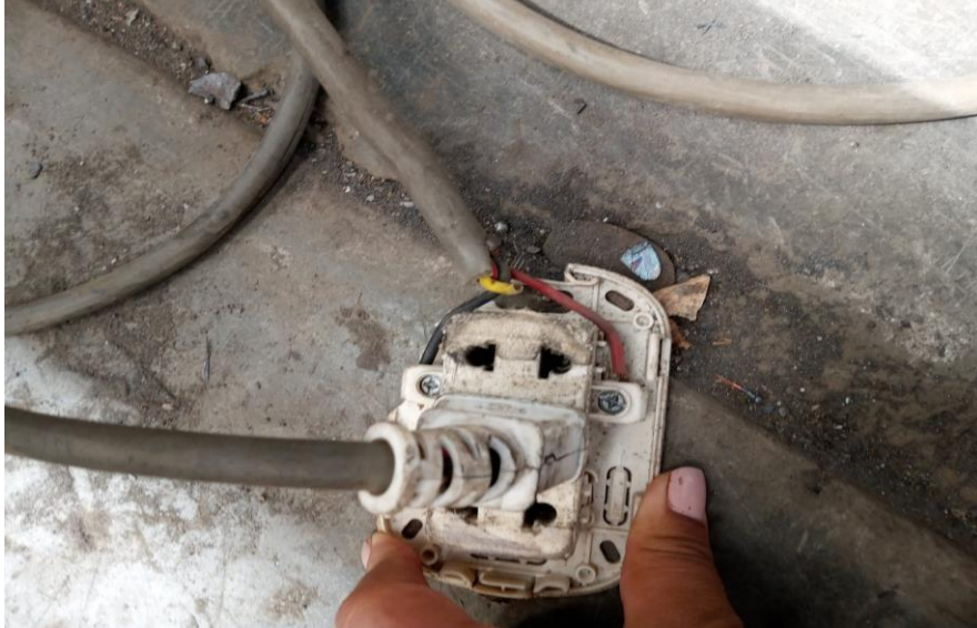
Figura 33: Tipo de peligro eléctrico.
