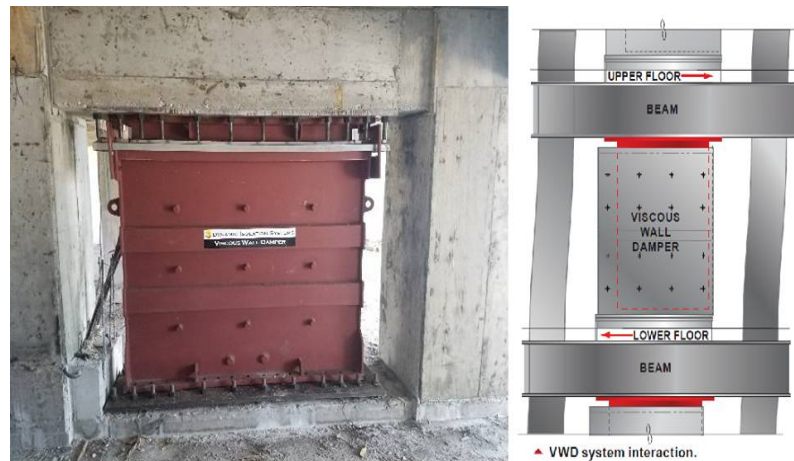
Figura 10: Muro Disipadores WVD (Wall Viscous Damper)
