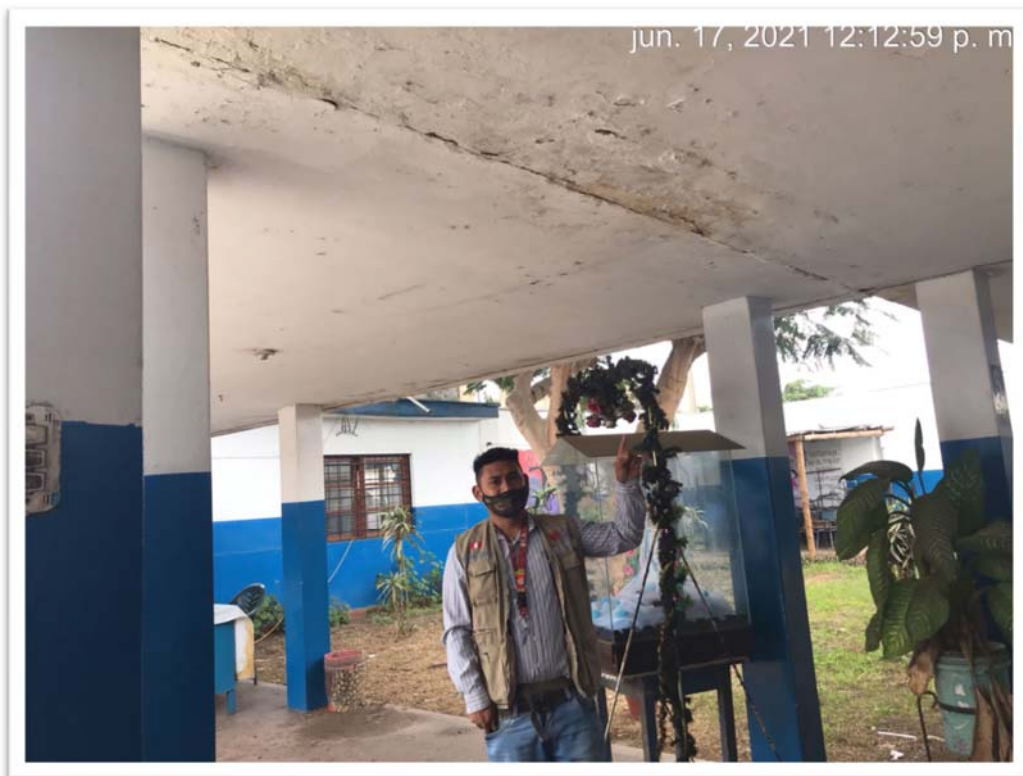
Foto 12. Falla en la viga de la estructura
