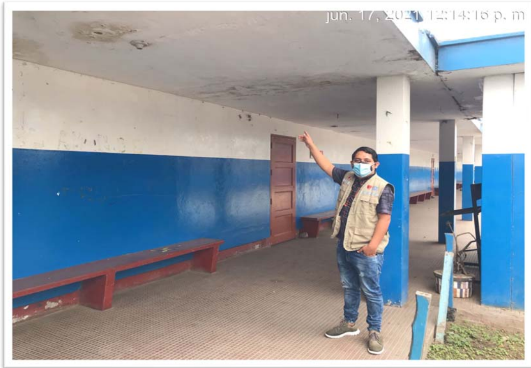
Foto 5. Falla en la parte de la estructura de la Institución Educativa
