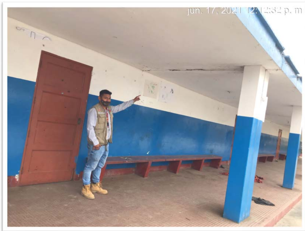
Foto 4. Falla de agrietamiento en la viga de la Institución Educativa
