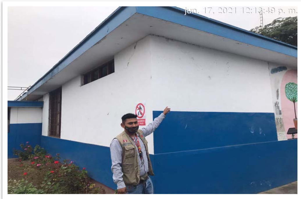
Foto 3. Agrietamiento en la pared
