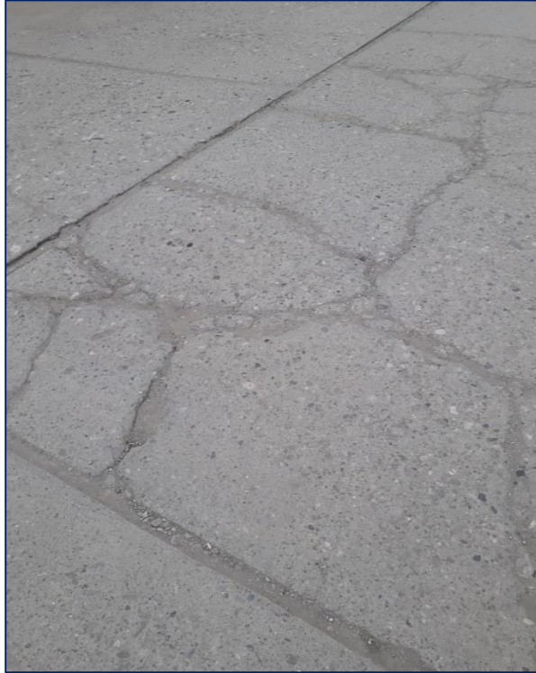
Figura 39: Pavimento con presencia de fisuras transversales Fuente: Elaborado por los autores
