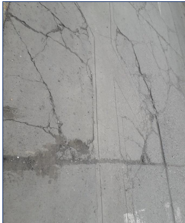
Figura 40: losa completamente dañada Av. Andahuaylas C-2 Fuente: Elaborado por los autores
