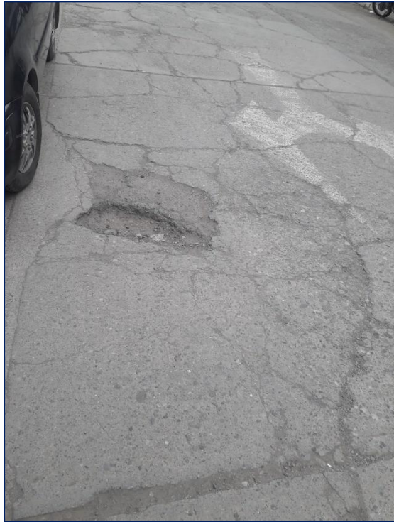
Figura 41: Losa completamente dañada Av. Andahuaylas C-1 Fuente: Elaborado por los autores
