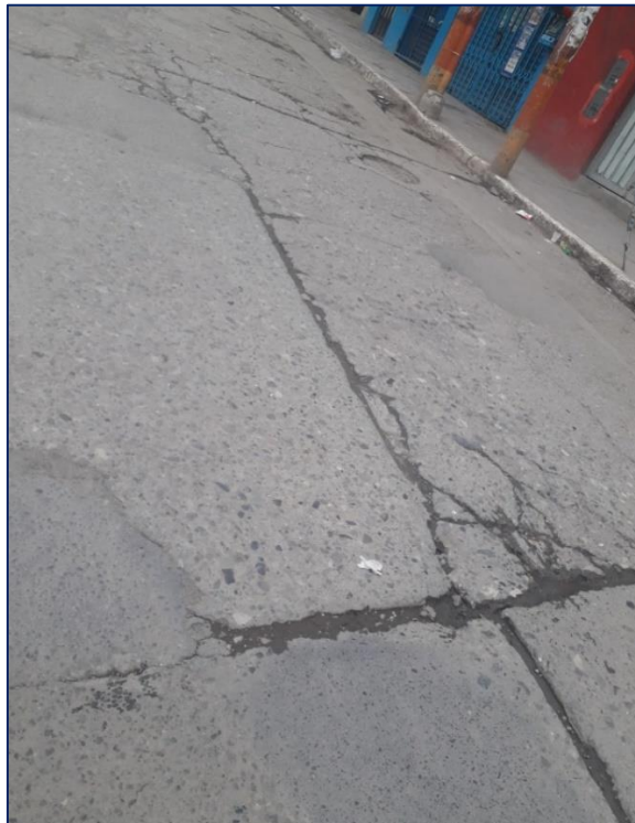
Figura 42: Despostillamiento de juntas Fuente: Elaborado por los autores
