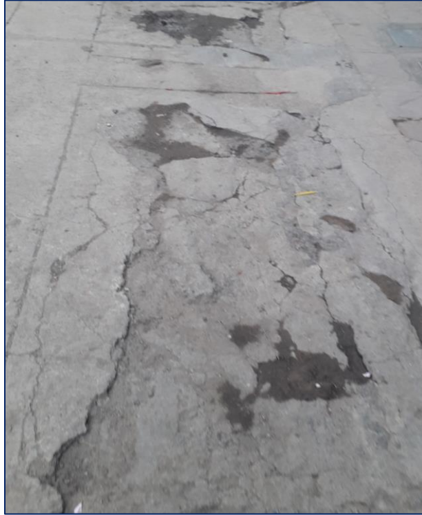
Figura 43: Desprendimiento de material C-1 Fuente: Elaborado por los autores
