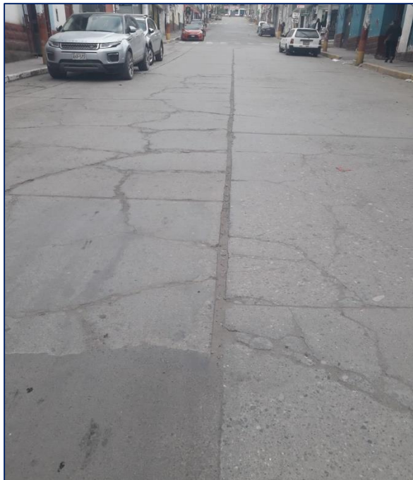
Figura 38: losa completamente dañada Av. Andahuaylas C-3 Fuente: Elaborado por los autores
