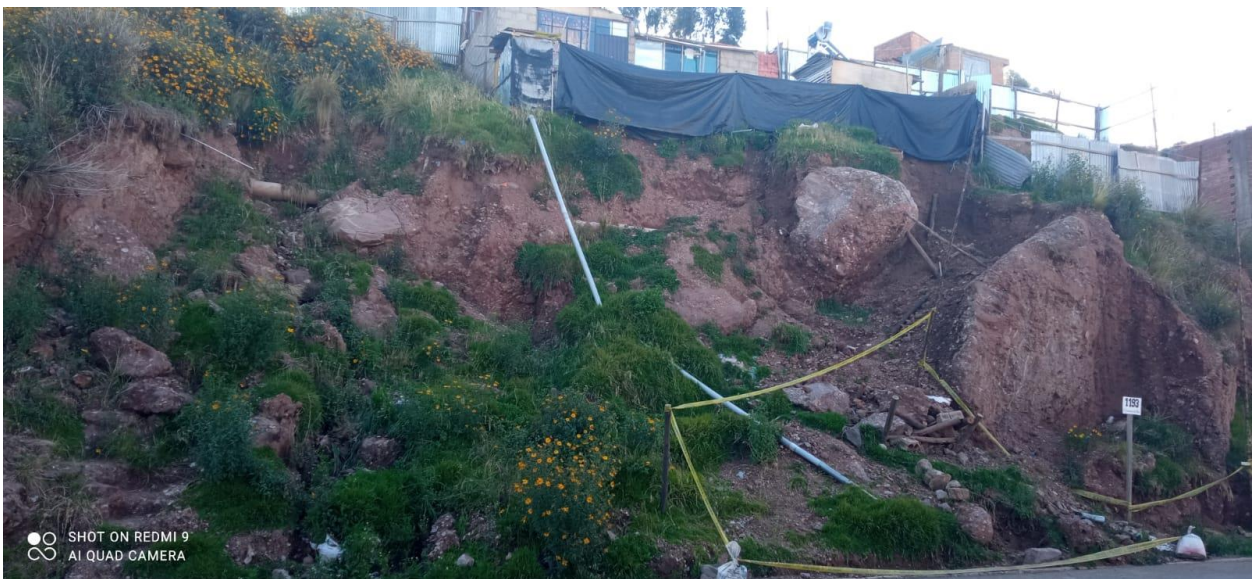
Imagen1: deslizamiento en sector de Llavini, en peligro las construcciones
