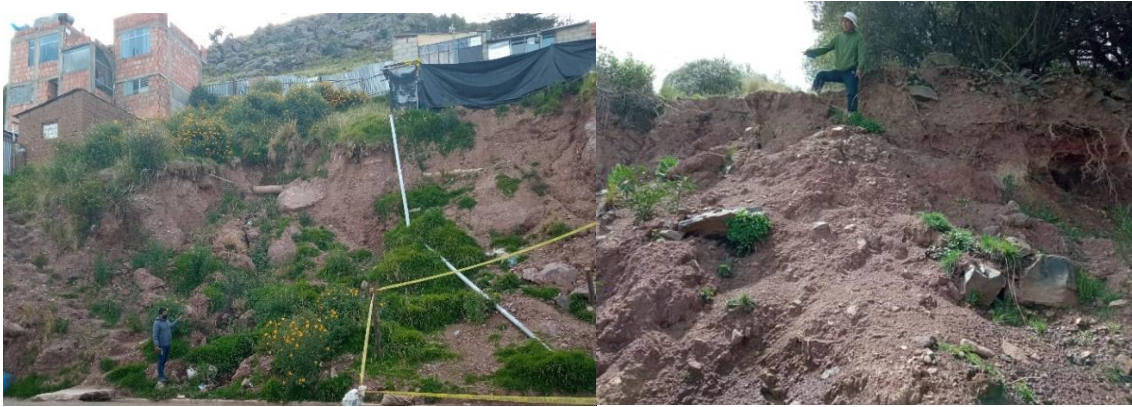
Figura 01. Construcción de viviendas podría estar en Riesgo.
