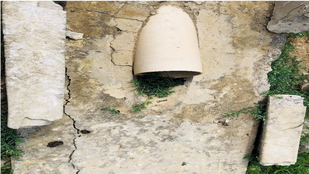
Figura 24 Identificando las patologías en los puntos de ingreso/salida
