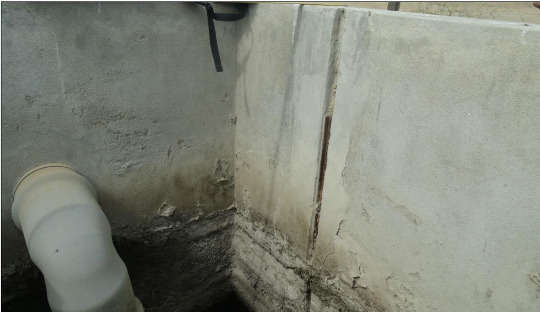
Figura 6 Identificando las patologías en la cámara de ingreso
