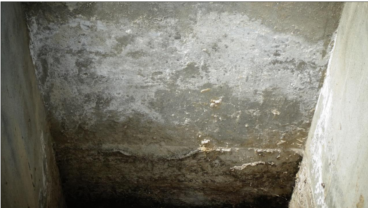
Figura 22 - Identificando las patologías en la cámara de inspección
