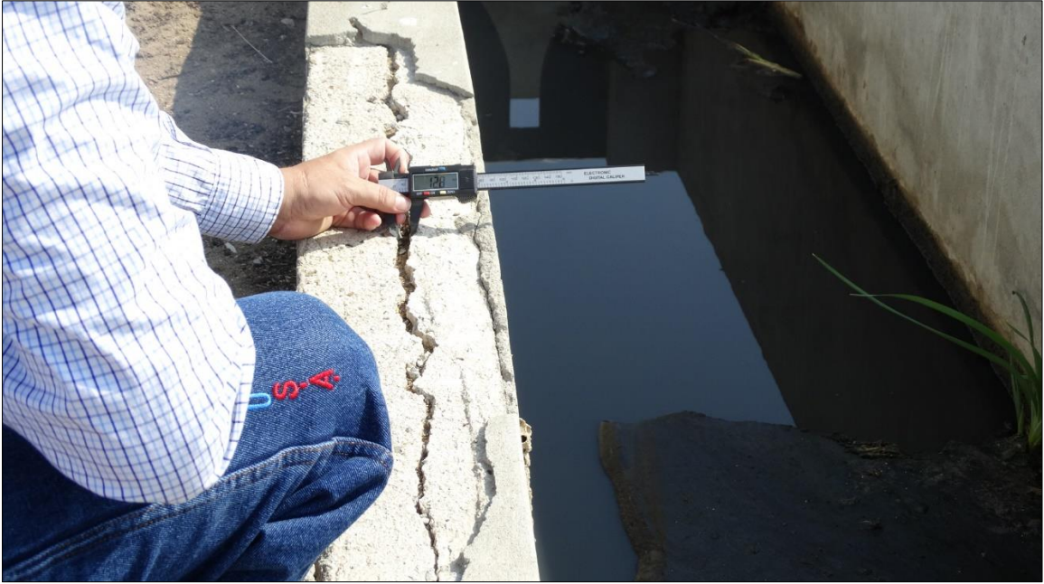
Figura 15 Midiendo tamaño de grietas en el desarenador
