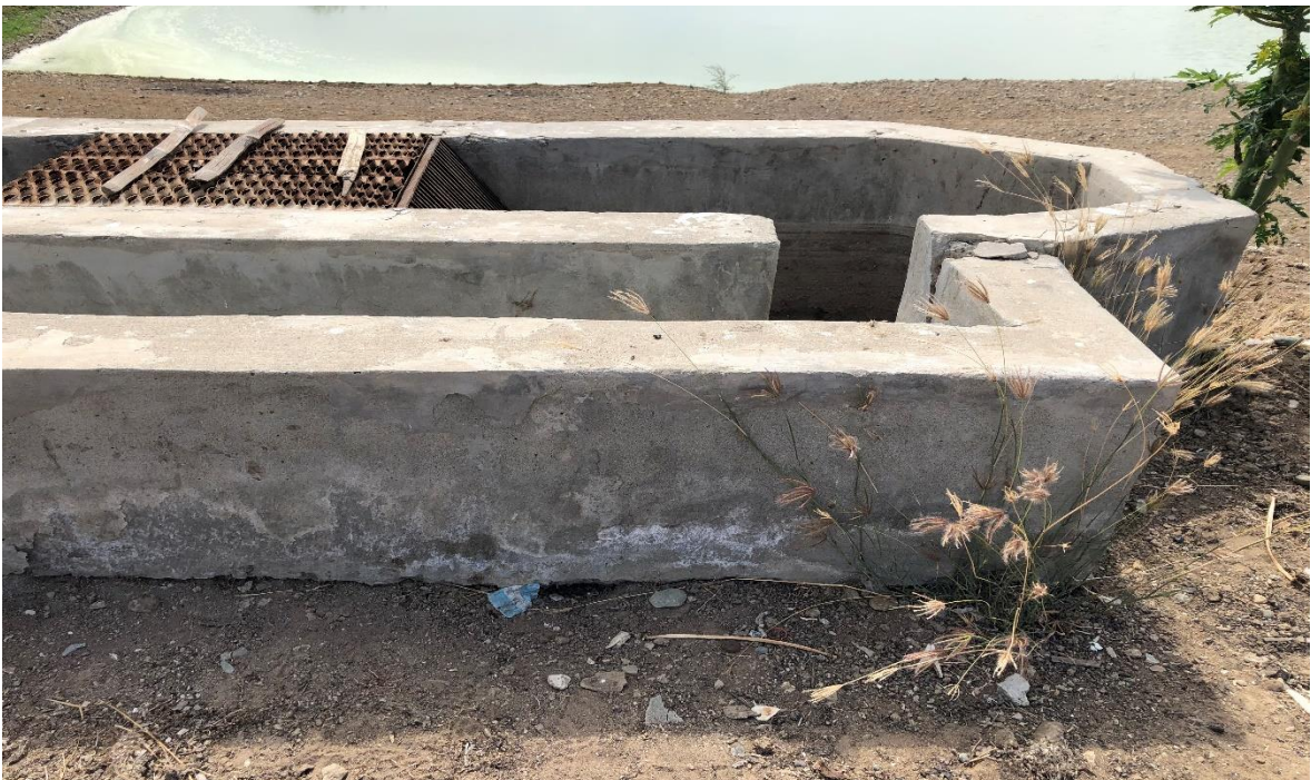
Figura 12 Identificando eflorescencia por ataque de sulfatos en la cámara de rejas
