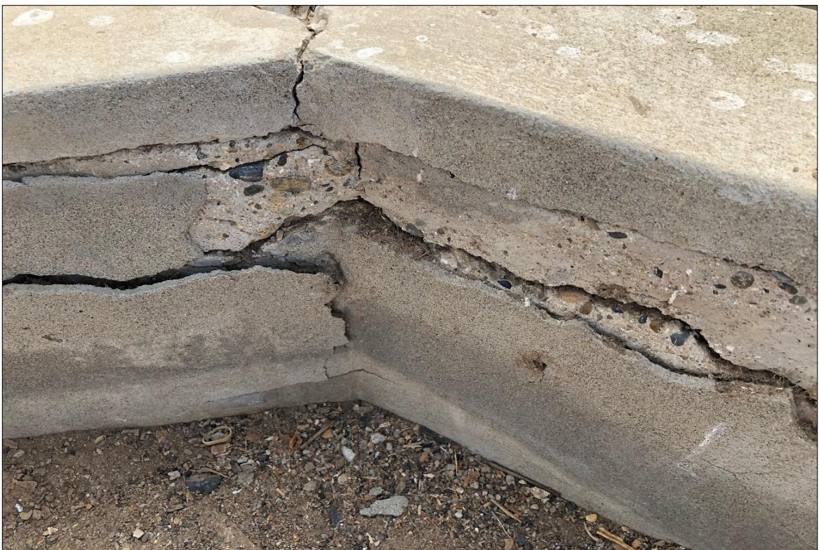
Figura 14 Identificando las patologías de descamación mecánica, grietas y humedad en el desarenador
