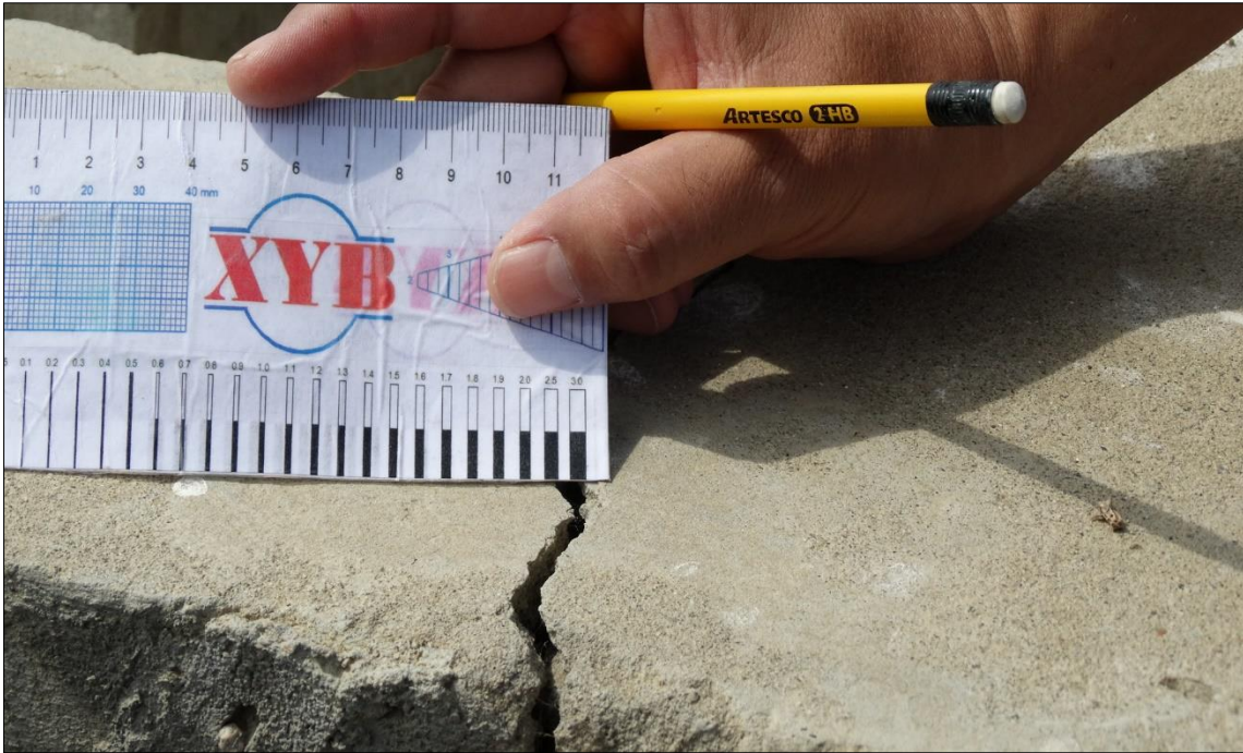
Figura 9 Identificando las patologías en la cámara de rejillas
