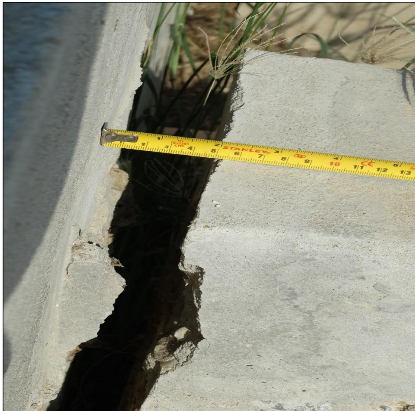
Figura 18 Toma de la medida de la fracturación del medidor Parshall
