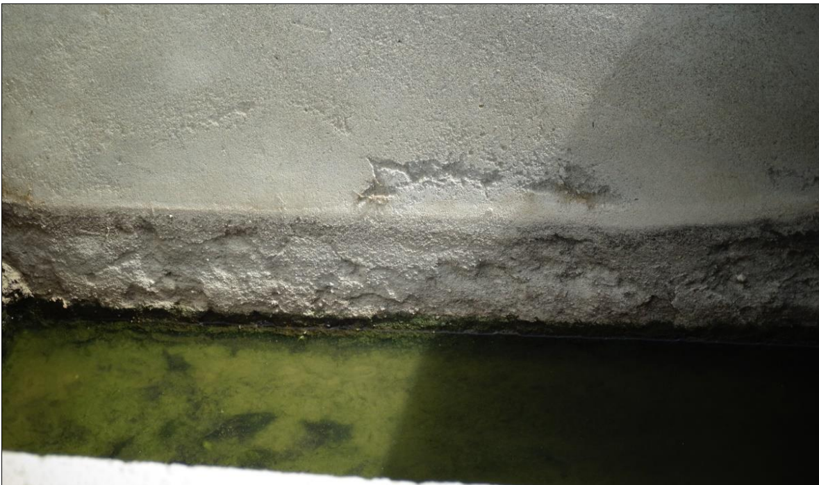
Figura 20 Identificando las patologías en la cámara de salida
