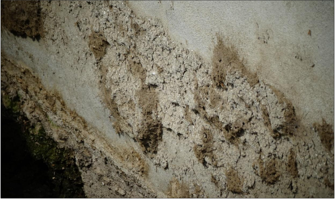
Figura 17 Identificando las patologías en el medidor Parshall
