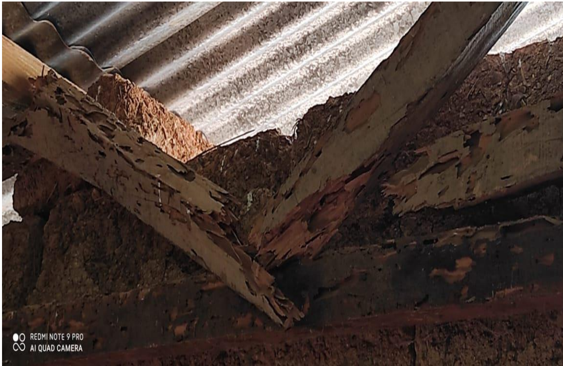
Anexo: 3 Tijeral de madera para techo Apolillado.
