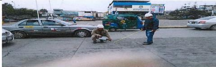
FOTO N° 3 : Realizando aplicación del ensayo con esclerómetro en la cara superior del pavimento rígido, con la finalidad de obtener su resistencia del concreto.
