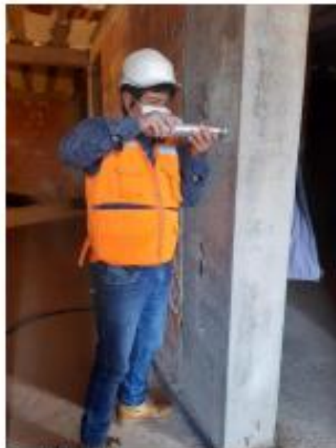
FIG. N° 3: Encierro en columna del 2do nivel
