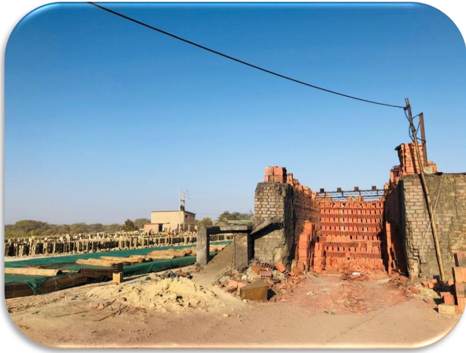
Figura 11: Horno con ladrillos luego del proceso
