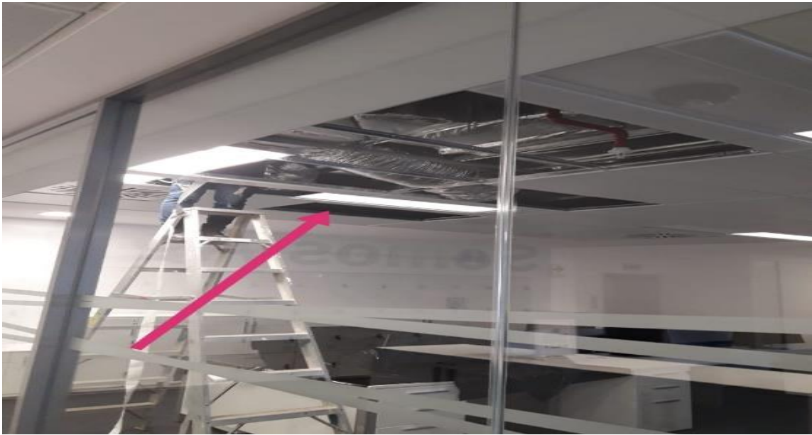
Figura 7: Aniego por obstrucción de drenaje de aire acondicionado Fuente: Propia
