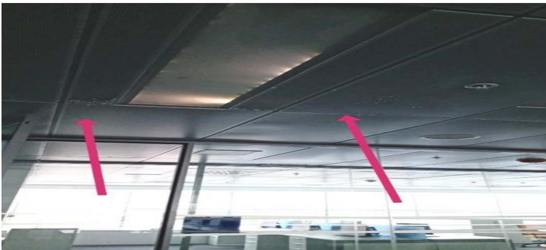
Figura 6: Goteo de aire acondicionado por bandeja sucia
