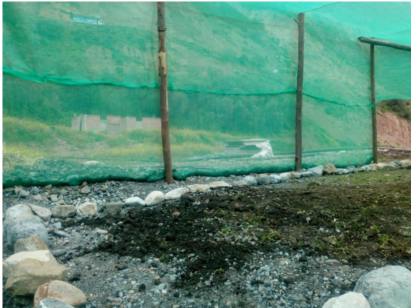
Figura 27. Acondicionamiento de lodos a las camas de tratamiento.
