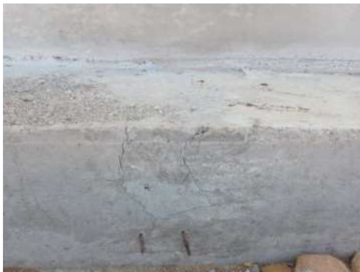
Figura 1 Fisuras de contracción por secado en el concreto armado.
