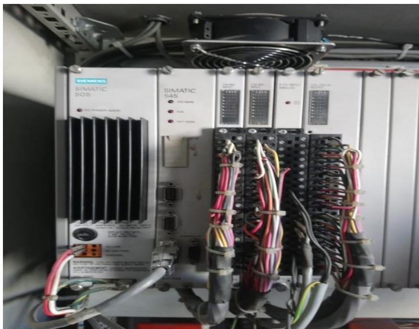
Figura : 6 , PLC Modular SIEMENS Fuente: (Propia, 2021)
