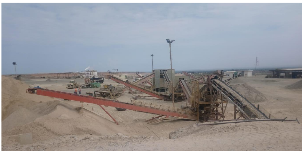
Figura : 12 , Planta de chancado Sojo Fuente: Elaboración propia, 2021
